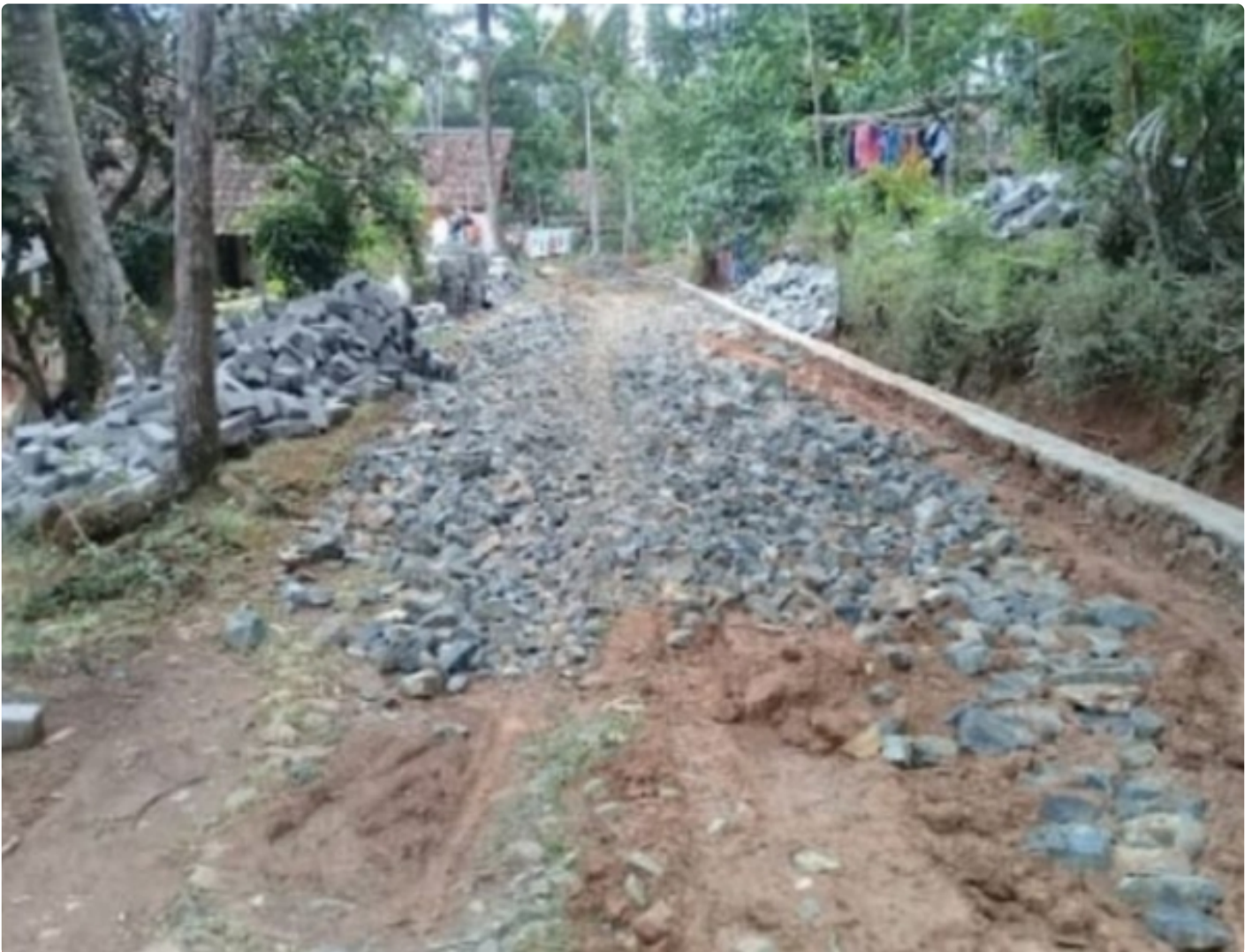
Proyek PISEW di Kecamatan Cimanggu Diduga Bermasalah
